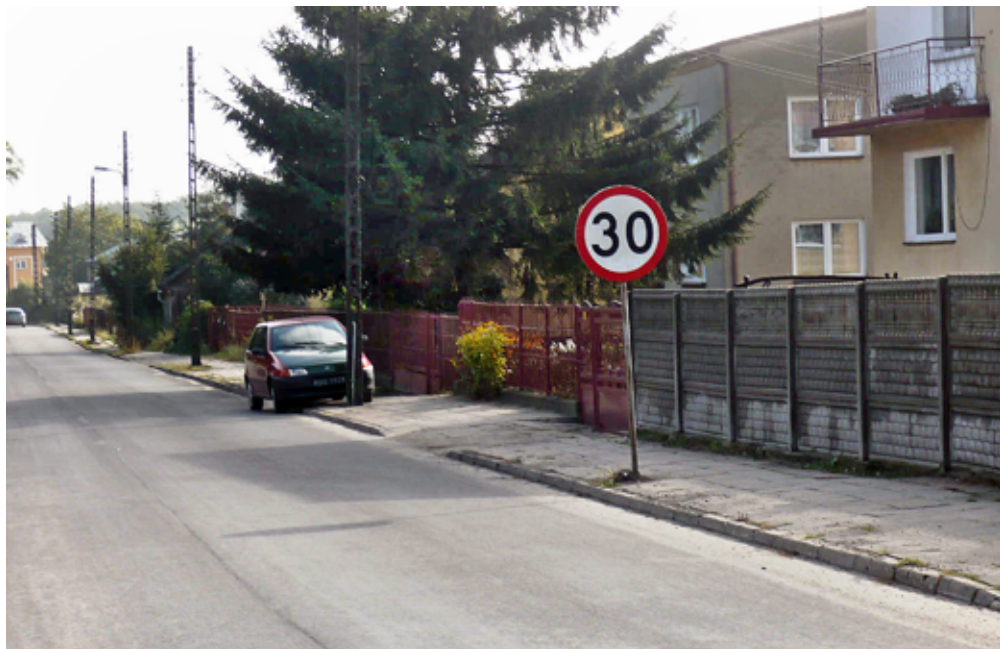
Chodniki przed modernizacją
